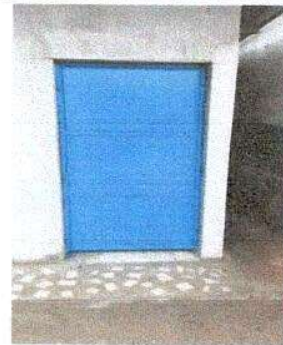
Foto 4: 4.3. PUERTA DE MADERA POR PUERTA DE METAL, EN COCINA
